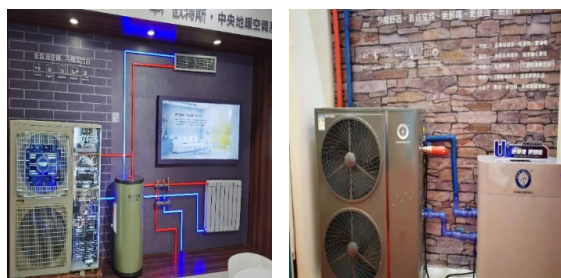
(c) 中广欧特斯地暖空调系统 (d) 纽恩泰地暖中央空调系统
